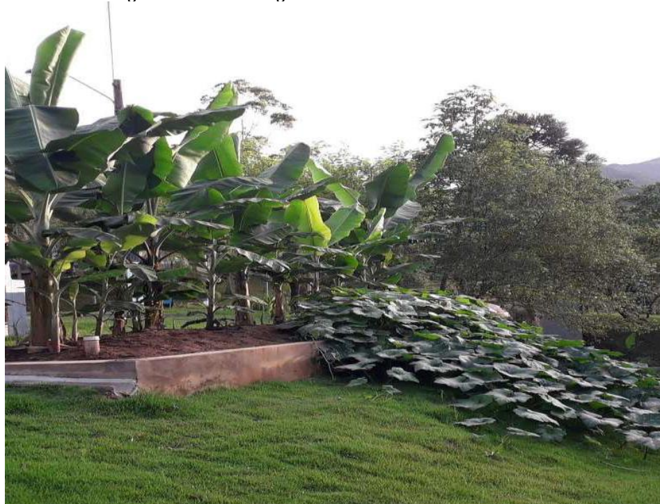
Figura 10 - Fossa ecológica instalada na Nova Rússia - Blumenau
