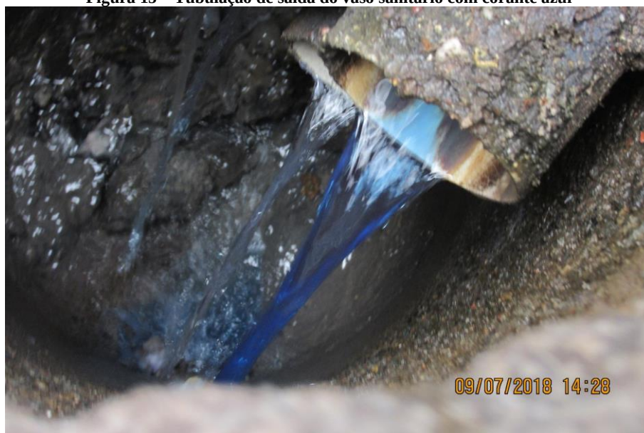
Figura 15 – Tubulação de saída do vaso sanitário com corante azul
